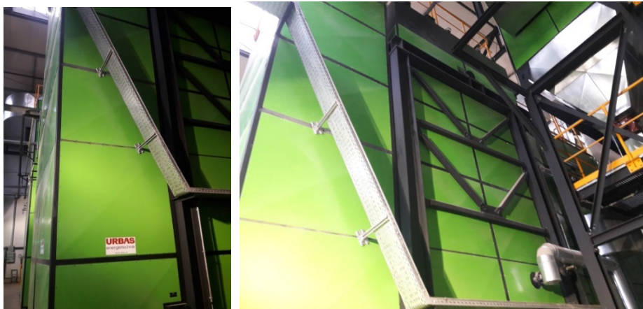
Slika 20. Kotlovi na drvenu sječku
